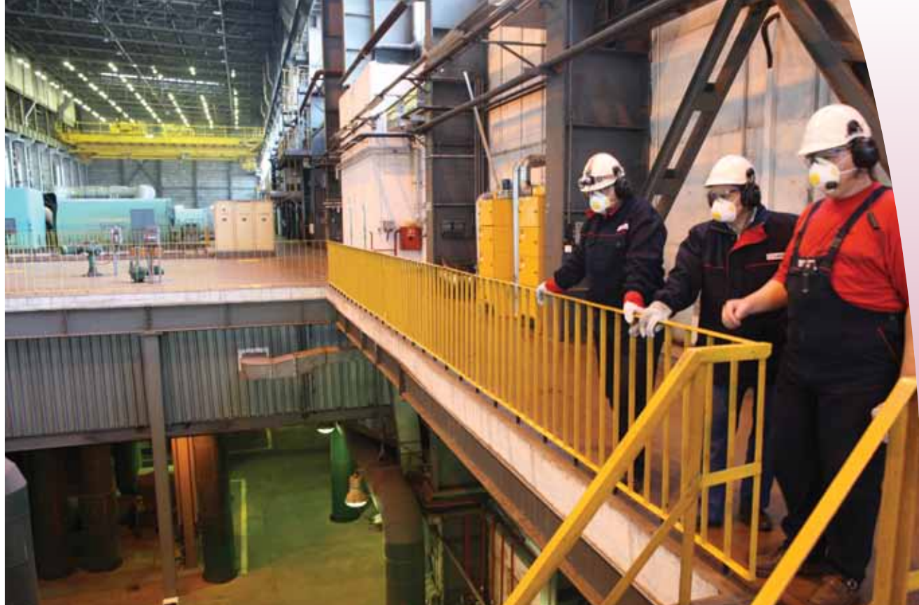
Personel techniczny maszynowni w elektrociepłowni w Poznaniu
