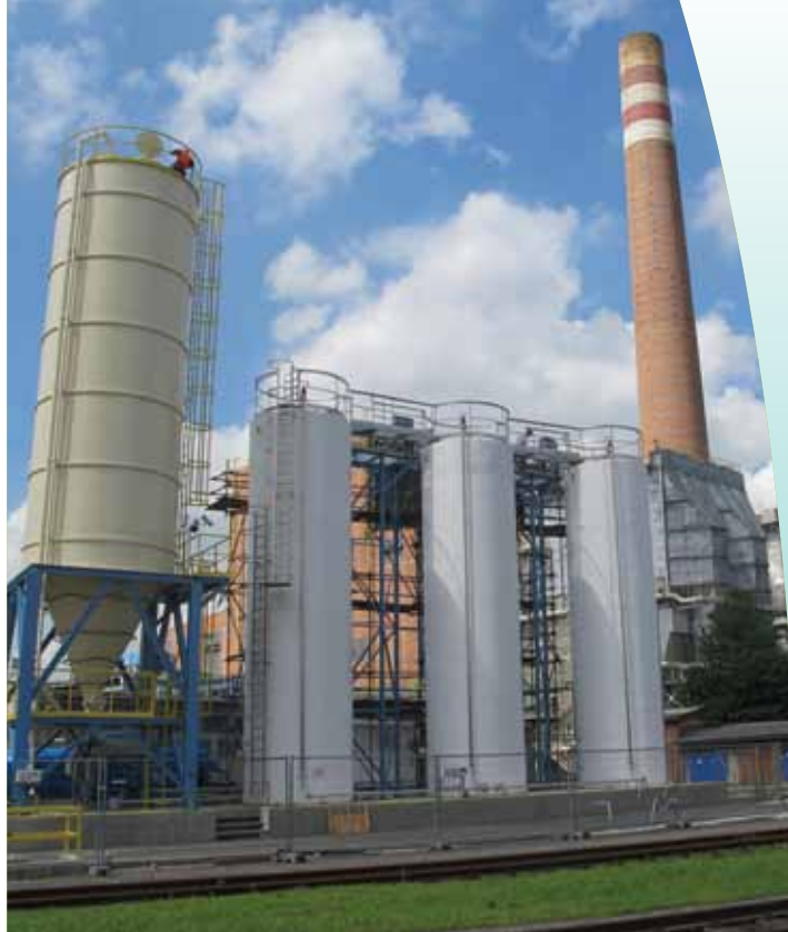
Nowa instalacja odazotowania w elektrociepłowni Trebowice, Ostrawa, Czechy
