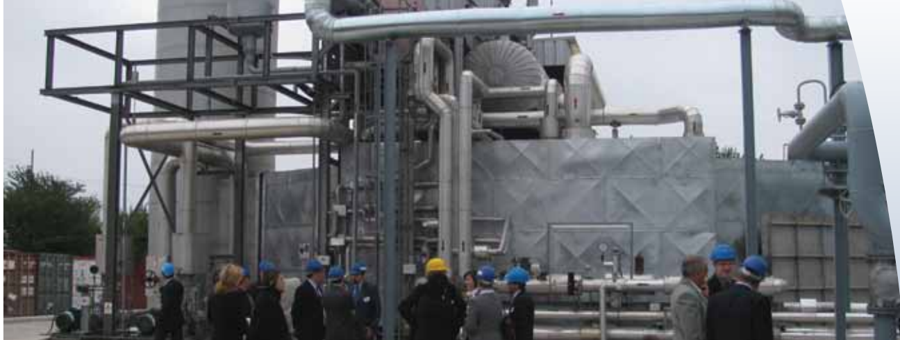
Nowa turbina gazowa w elektrociepłowni Brazi/Ploeshti
